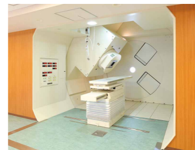
陽子線センター 回転照射室
